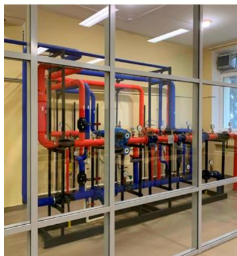
Теплоснабжающий полигон жилищно-коммунального хозяйства
